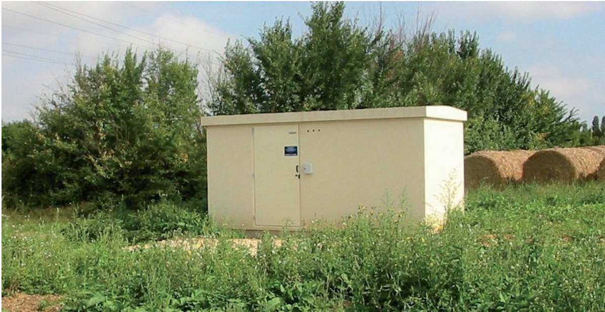
Figure 9 : Photographie d'un poste de livraison type
